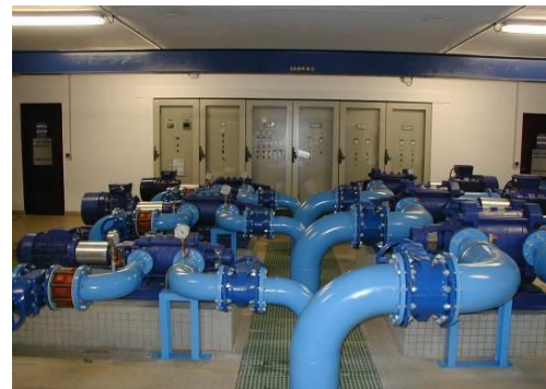
Vue générale de la salle de pompage
