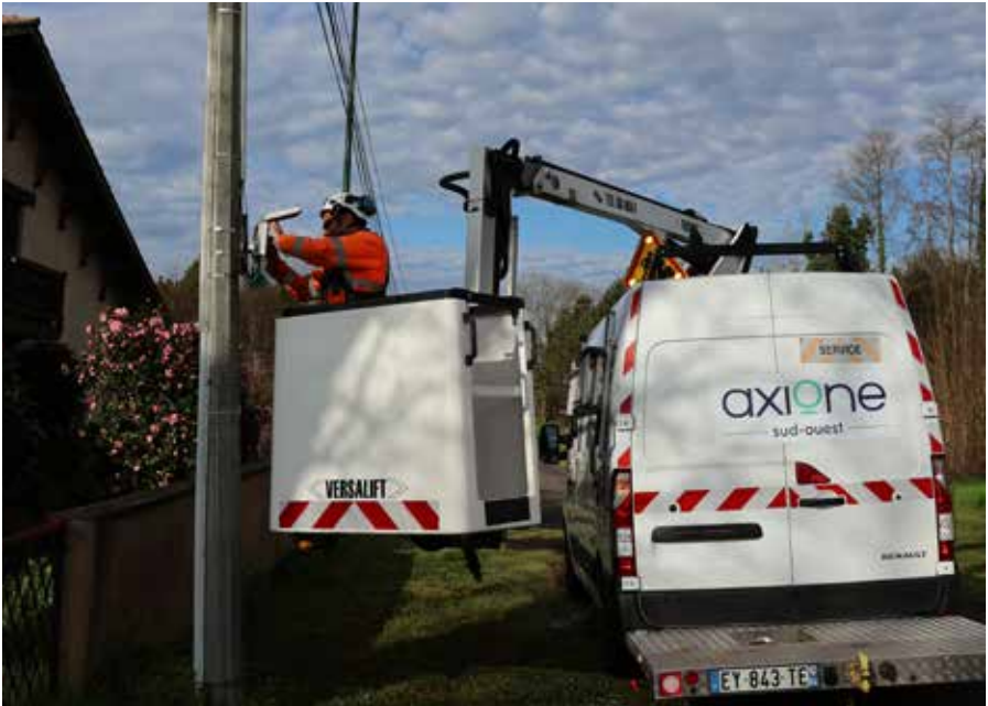
Maintenance sur un Point de Branchement Optique, par La fibre Nouvelle Aquitaine (LFNA) filiale du groupe Axione, prestataire de NATHD
